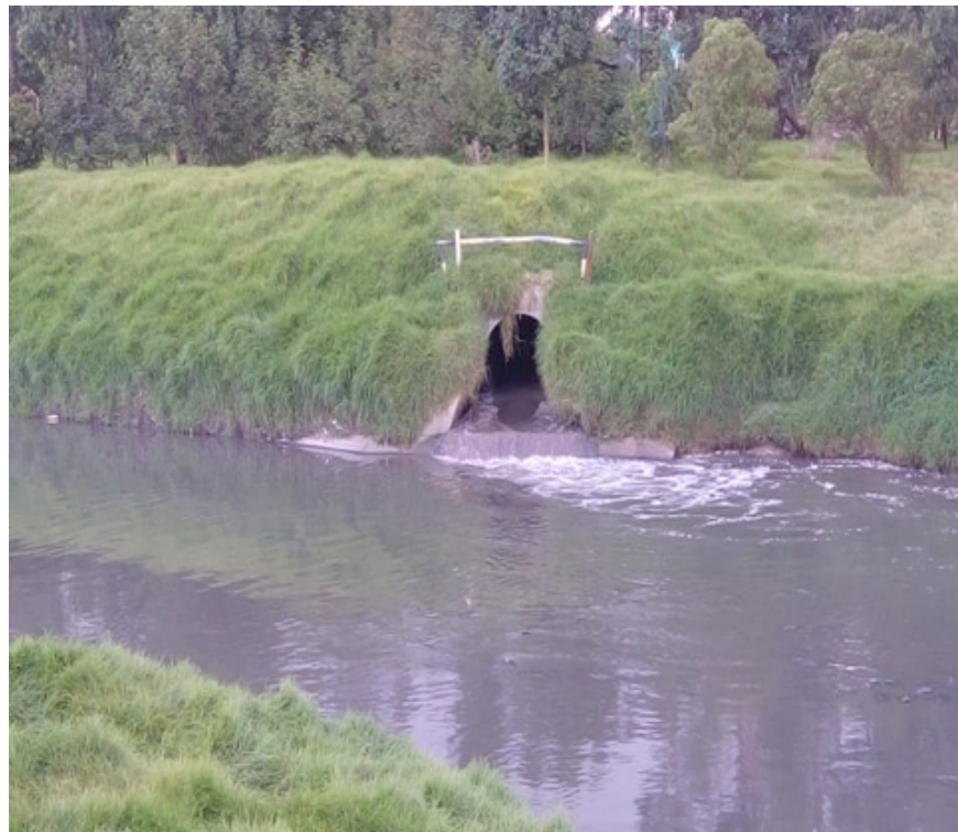
Estación de Bombeo Fontibón, río Fucha
