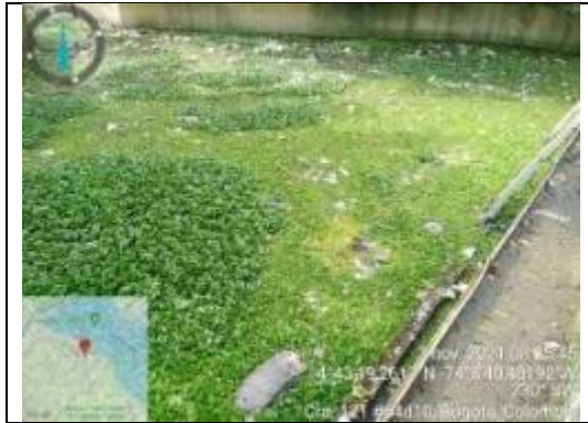
Figura 30 Se evidencia alta acumulación de RSO por arrastre del agua, la rejilla evita el ingreso al canal que no se encuentra adosado – 03/11/2021
