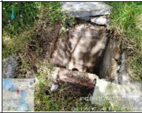
Figura 96 Caja sistema eléctrico alumbrado público Registro del 05/11/2021
