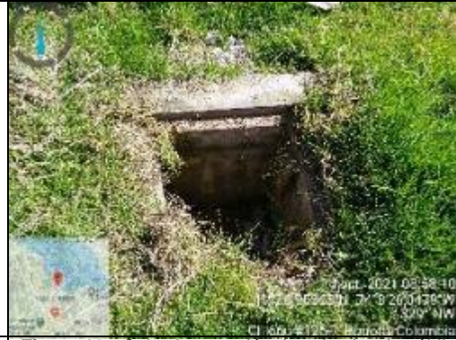
Figura 107 Caja sistema eléctrico alumbrado público Registro del 14/10/2021
