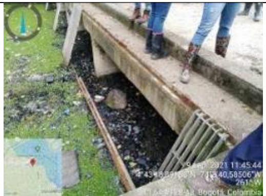
Figura 29 Presencia de residuos sólidos ordinarios en esta parte final del canal revestido., 09/09/2021
