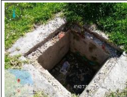
Figura 110 Caja sistema eléctrico alumbrado público Registro del 14/10/2021
