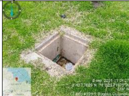
Figura 109 Caja sistema eléctrico alumbrado público Registro del 08/09/2021
