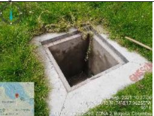
Figura 104 Caja sistema eléctrico alumbrado público Registro del 08/09/2021
