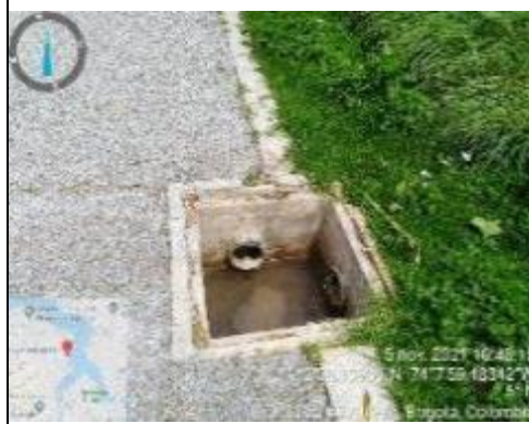
Figura 92 Caja sistema alcantarillado pluvial Registro del 05/11/2021
