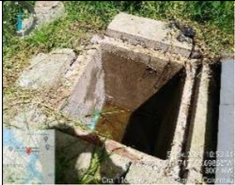
Figura 98 Caja sistema eléctrico alumbrado público Registro del 05/11/2021
