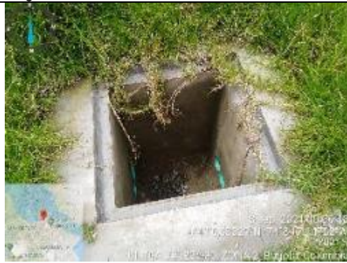
Figura 103 Caja sistema eléctrico alumbrado público Registro del 08/09/2021
