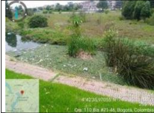
Figura 31 Es REITERATIVA la presencia de residuos sólidos ordinarios en este sector del canal perimetral cerca al box coulvert de Villa Amalia. 09/09/2021
