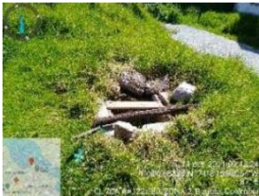
Figura 100 Caja sistema eléctrico alumbrado público Registro del 14/10/2021
