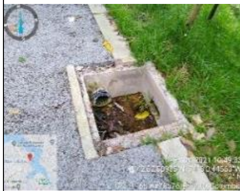
Figura 94 Caja sistema alcantarillado pluvial Registro del 05/11/2021
