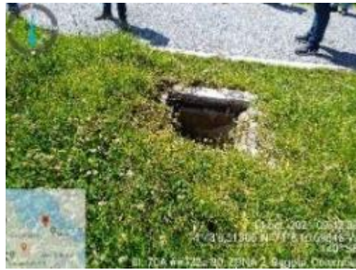
Figura 101 Caja sistema eléctrico alumbrado público Registro del 14/10/2021
