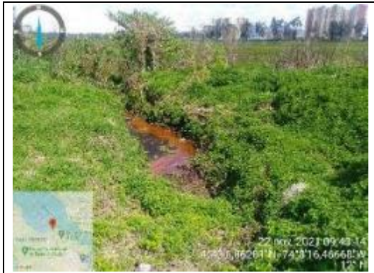
Figura 17 Vertimiento en borde sur tercio medio sector Santa Librada, se realizó despeje de cabezal de alcantarillado se presume el cabezal corresponde a aguas lluvias.- 22/11/2021
