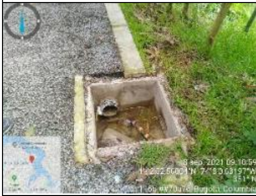
Figura 95 Caja sistema alcantarillado pluvial Registro del 05/11/2021
