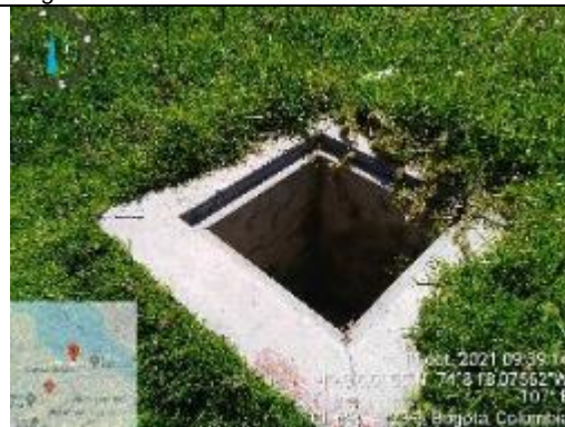
Figura 105 Caja sistema eléctrico alumbrado público Registro del 14/10/2021
