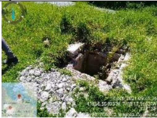
Figura 102 Caja sistema eléctrico alumbrado público Registro del 14/10/2021
