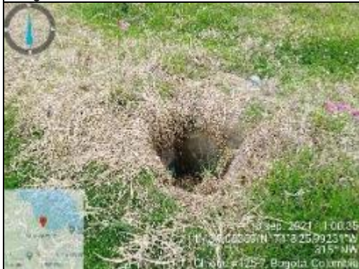
Figura 108 Caja sistema eléctrico alumbrado público Registro del 08/09/2021
