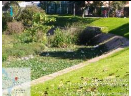
Figura 34 Es REITERATIVA la presencia de RSO en canal perimetral en este sector. 05/11/2021
