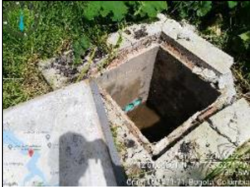
Figura 97 Caja sistema eléctrico alumbrado público Registro del 05/11/2021
