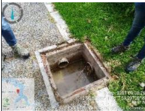
Figura 93 Caja sistema alcantarillado pluvial Registro del 05/11/2021
