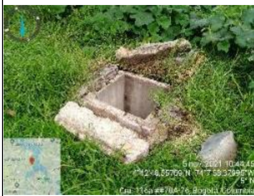
Figura 91 Caja sistema eléctrico alumbrado público Registro del 05/11/2021
