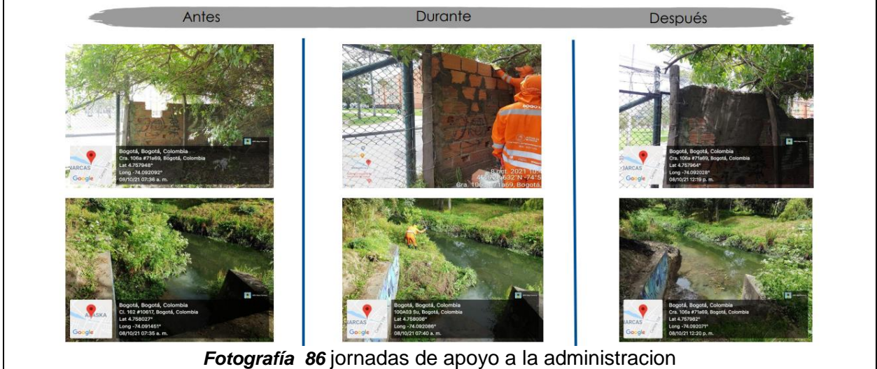
Fuente: Contrato de mantenimiento EAB – AB 9-99-24300-0867-2021
