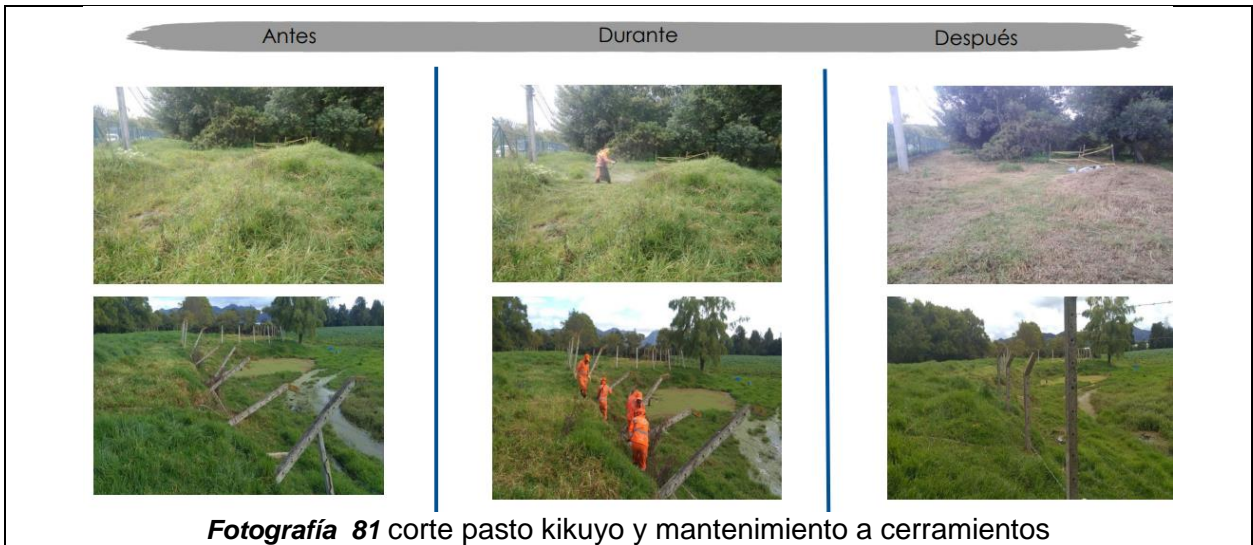
Fuente: Contrato de mantenimiento EAB – AB 9-99-24300-0867-2021
