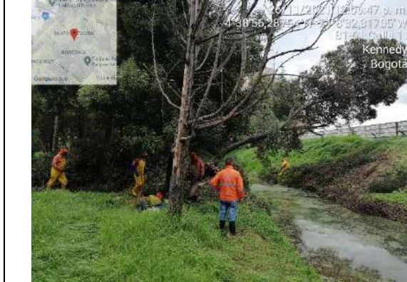
Retiro de árbol caído sobre canal perimetral sector 2 PEDHTE.
