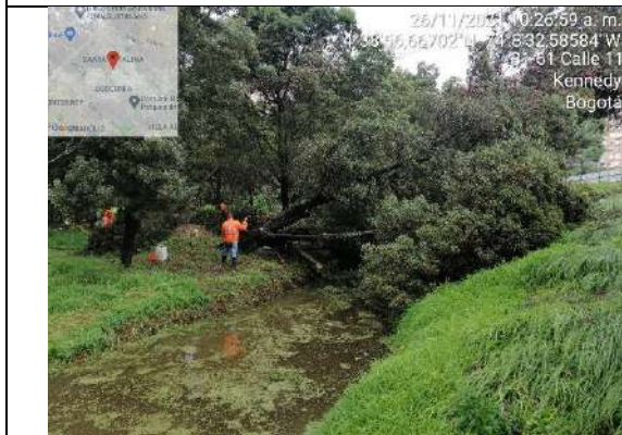
Retiro de arbol caido sobre canal perimetral sector 2 PEDHTE.
