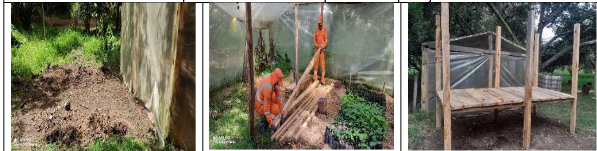
Instalación cosechadora de agua
