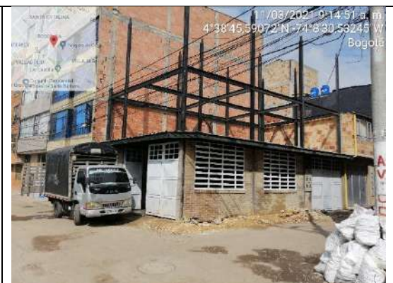
Fotografía 75 Verificación de tensionantes construcciones ilegales
