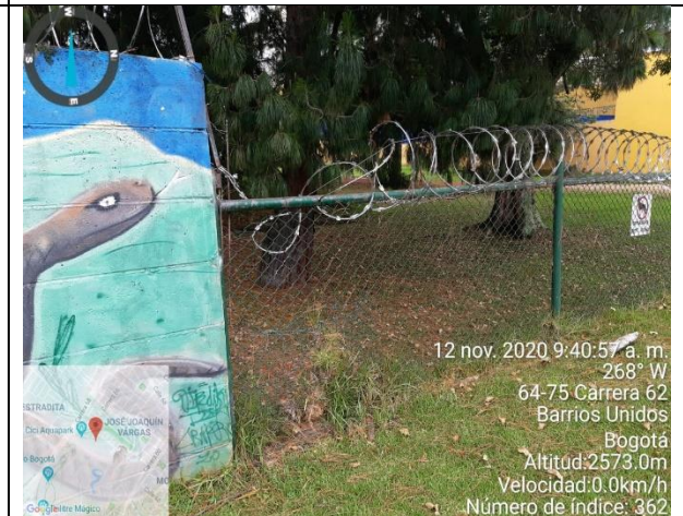
Imagen 6 Ruptura malla del cerramiento
